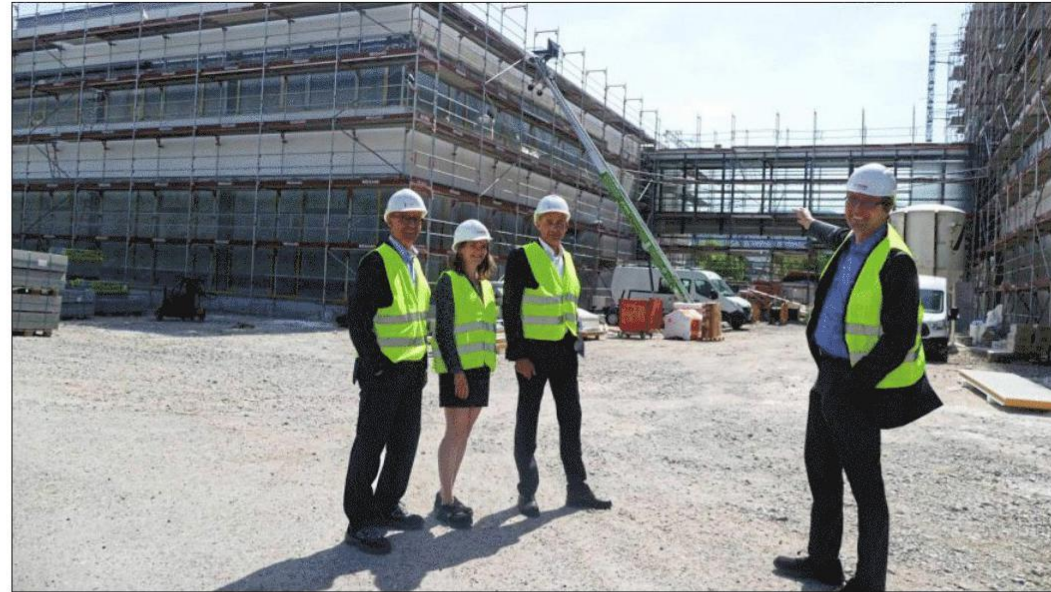
ORTSTERMIN AUF DER BAUSTELLE: Bernhard Straub, Vanina Haas, Ulrich Vogel und Gregoire Jedrzychowski vor dem Neubau des internationalen Entwicklungszentrums in Bühl. Foto: Lienhard
